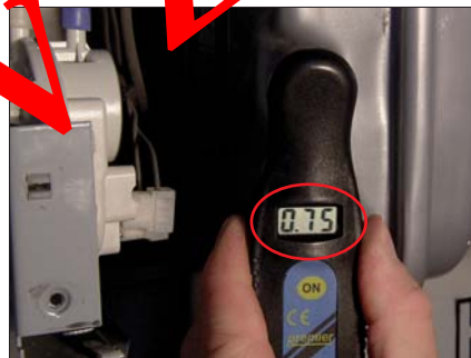
Obr. 5 Kontrola tlaku expanzní nádoby (požadovaná hodnota tlaku)
