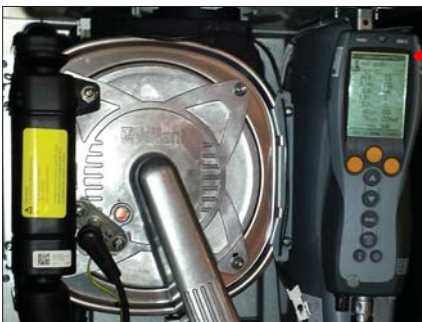
Obr. 4 Měření hodnot NOx ve spalínách a plynové nastavení
