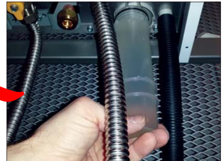
Obr. 3 Kontrola odvodu kondenzátu a čištění sifónu
